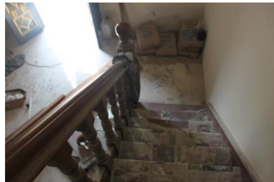
Gambar 18. Tangga menara masjid dalam proses perbaikan dan pengecatan ulang (Sumber: Dokumentasi Pribadi, 2017)
