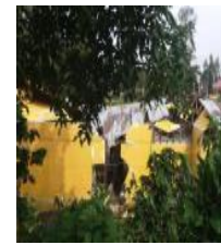
Bangunan Pujasera Rusak
