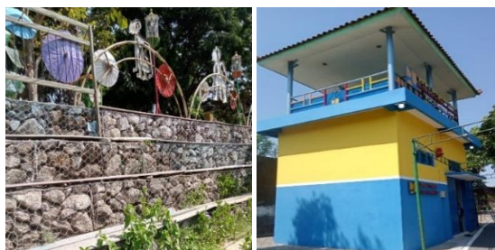
Gambar 2a (kiri). Pengendali Jurang. Gambar 2b (kanan) Rumah Pompa.
