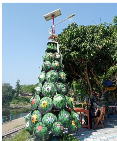
Gambar 5. Alat Penerangan Jalan dengan Panel Surya
